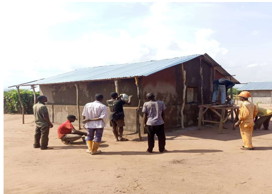
Bénéficiaires formés au renforcement des abris durables dans le cadre du projet de villagisation de l'UNHCR via son partenaire AIDES au Kasaï Central. ©UNHCR/Clarisse
